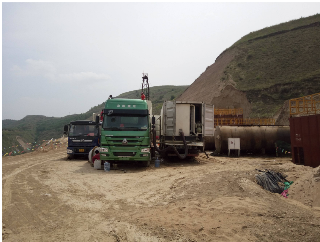
全套移动式处理装置：现场就位
