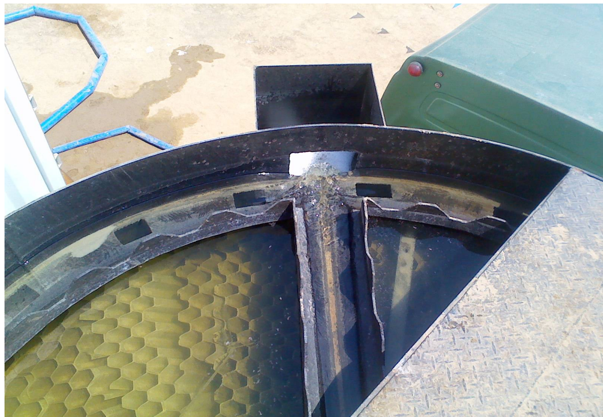
预处理装置出水
