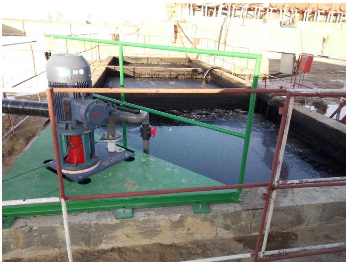
卸污池及污水提升泵
