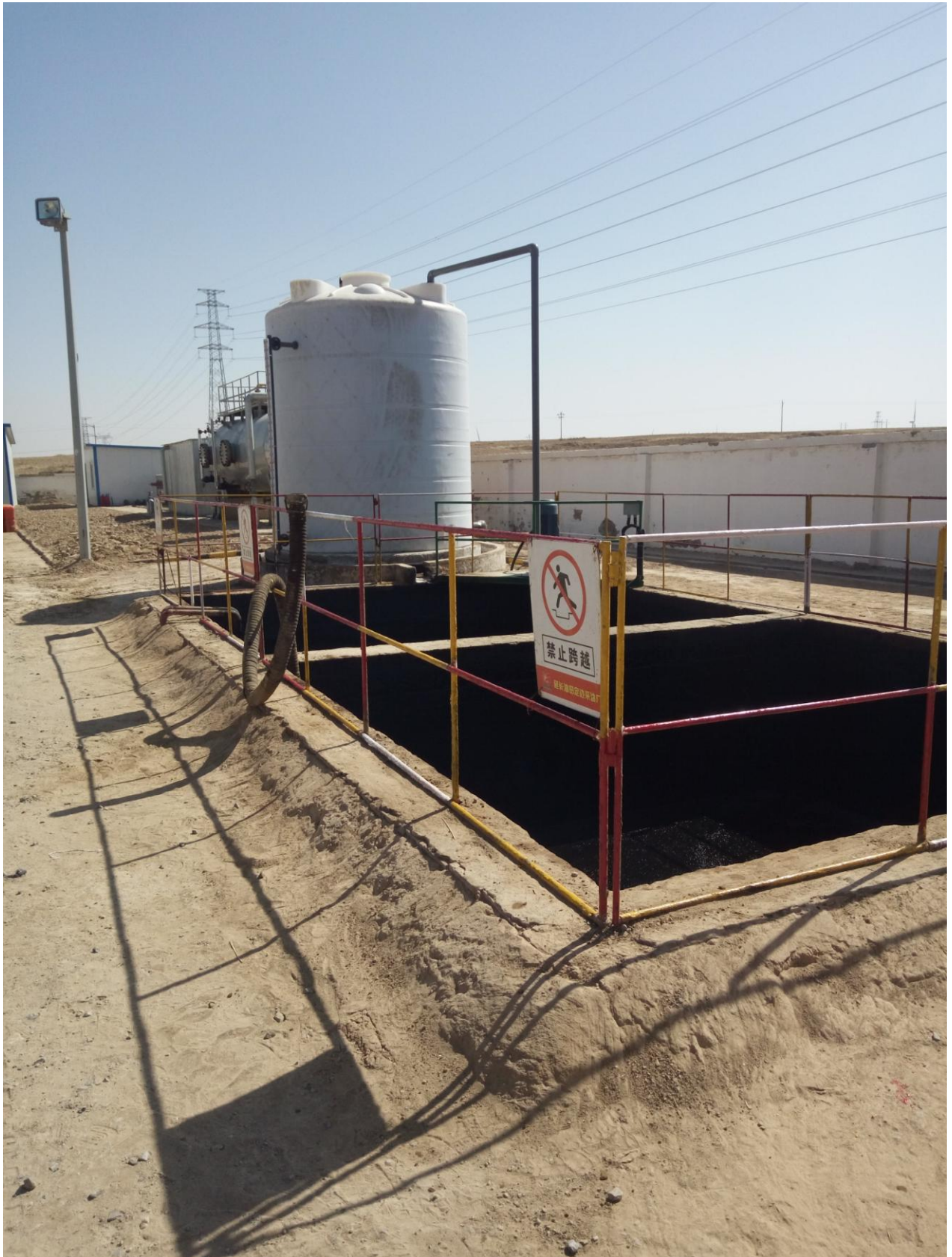
卸污池、污水提升泵、污水沉降箱
